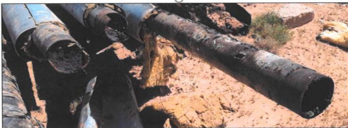
Рисунок 16- Отрезки труб с линии на входе в ОГ-200
